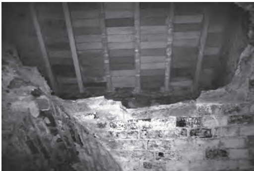
La volta d'aresta, amb el forat que permet accedir a la primera planta. Al fons el sostre de biguetes de formigó.
