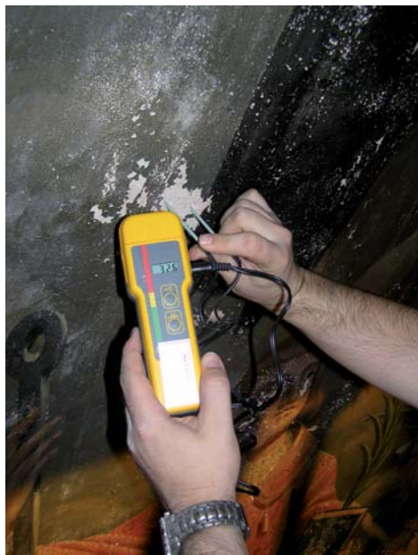
Mesuraments d'humiditat en la superfície afectada per filtracions
