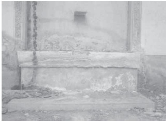
Detall frontal de l'altar major, on s'aprecia la pèrdua de material.
