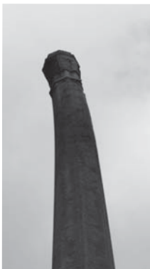
Desplom. Vista general.
