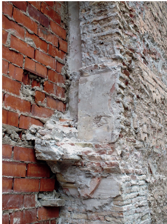
Figura 9. Restes de les motlures de l'interior de l'arc de la capella de la Comunió.
