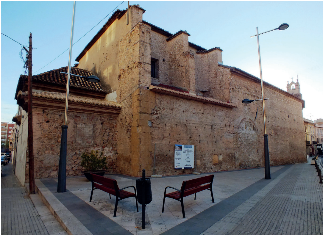
Figura 3. Façana sud amb els contraforts del presbiteri i el reforç de la cantonada.
